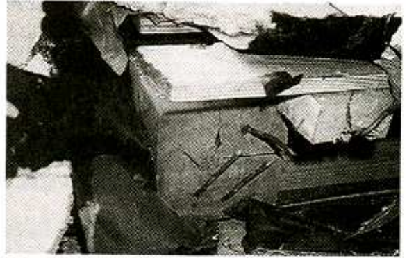
写真一二 手抜き工事の柱 釘3本に注意
